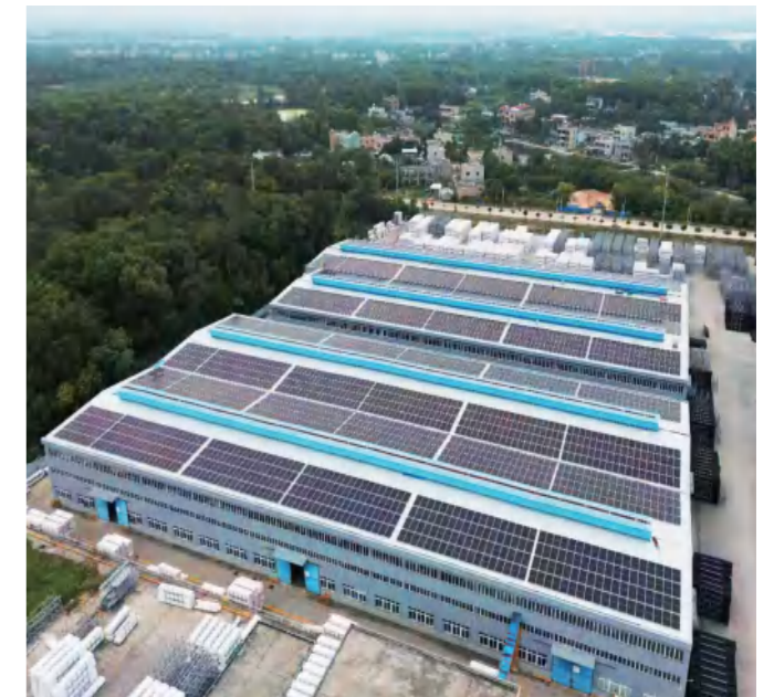
Estación de Energía Solar en Techo de Dingan
