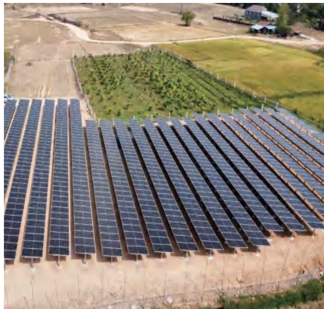
Planta de energía solar de fábrica de hielo Snowflake
