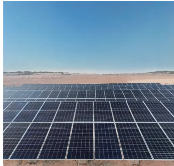
Central eléctrica de bombeo solar
