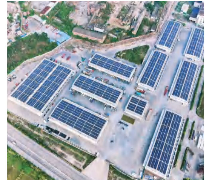
Estación de Energía Solar en el Techo de Maoming Logistics
